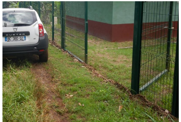
Traces d'écoulements pluviaux depuis la piste en léger surplomb vers la parcelle clôturée.
