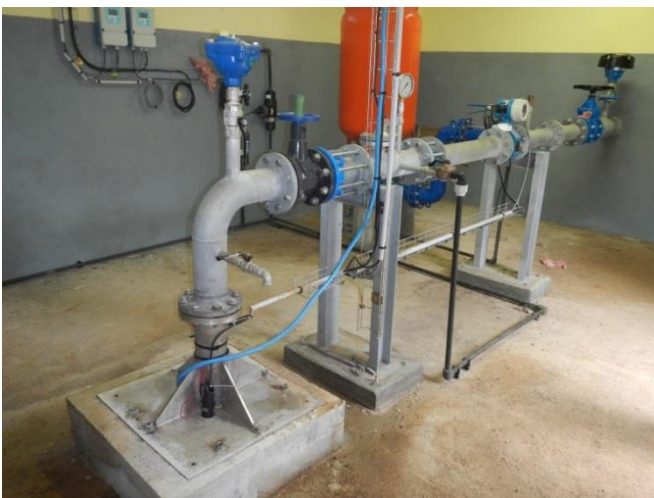
Installations du forage de Béja 2
